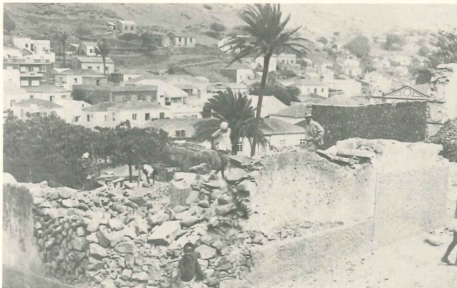
Preparação do terreno para o início das obras do novo templo da Vila da Ribeira Brava.
